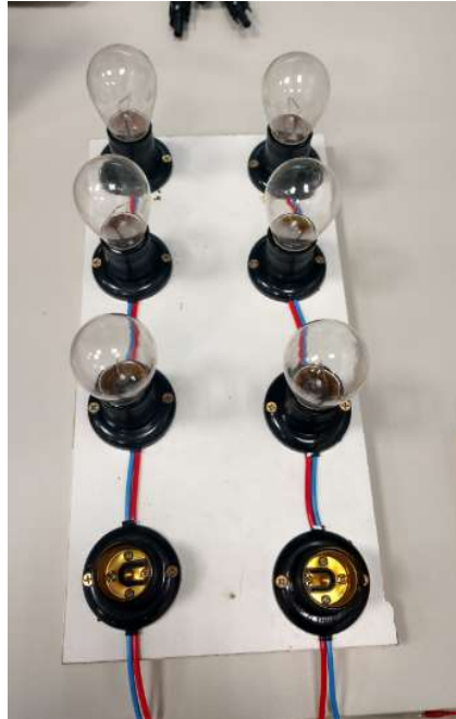
Figura 4 - Ligação das lâmpadas incandescentes em paralelo as Placas fotovoltaicas, como carga do sistema.
