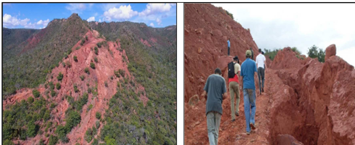
Figura 4. Trecho de obras inacabadas da estrada de acesso à Chapada das Mangabeiras.
