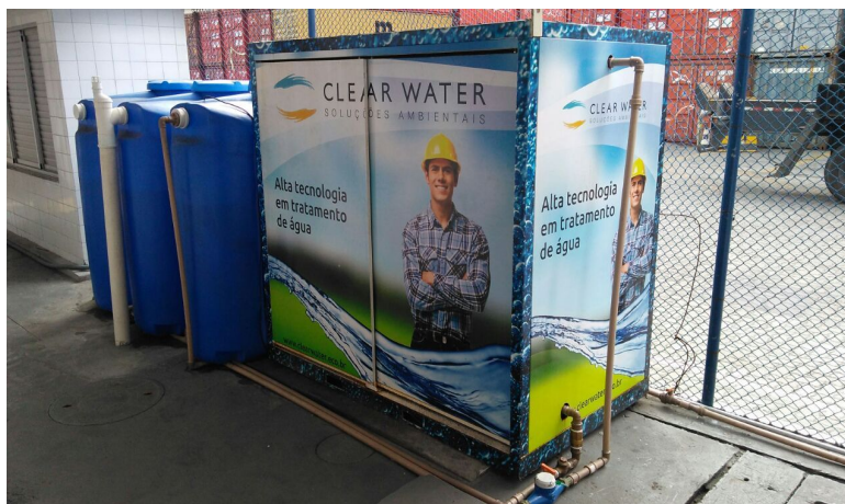
Figura 3: Estação de Tratamento de Reuso de águas cinza.
