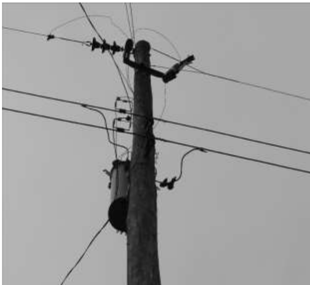
Figura 5: Rede MRT, transformador monofásico.
