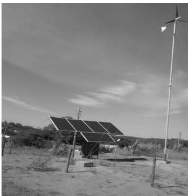
Figura 1: Aerogerador e Painel fotovoltaico - sistema híbrido
