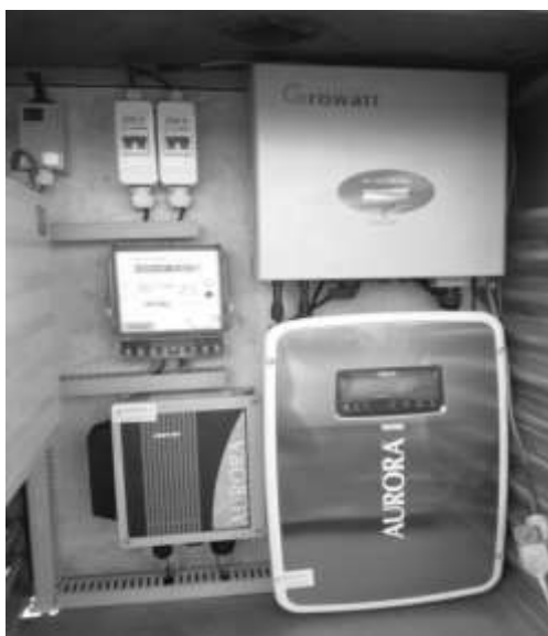
Figura 2: Quadro geral dos equipamentos e sistemas de proteção
