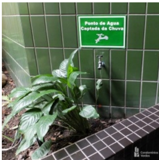
Figura 4 – Sinalização nas torneiras exclusivas para água de reuso.
