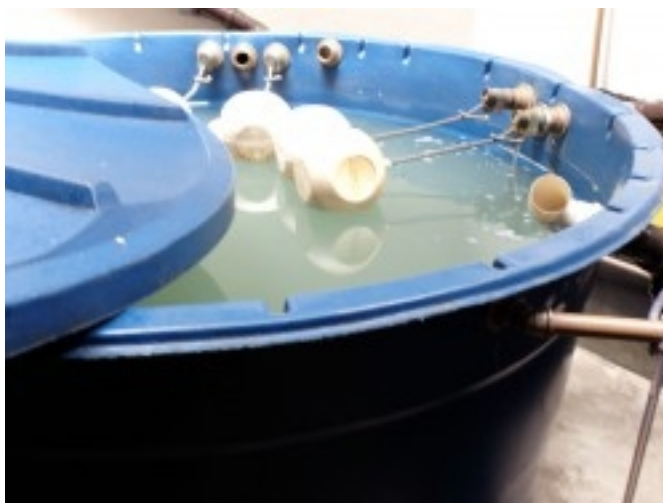
Figura 3 -Caixas que funcionam como reservatório da água captada
