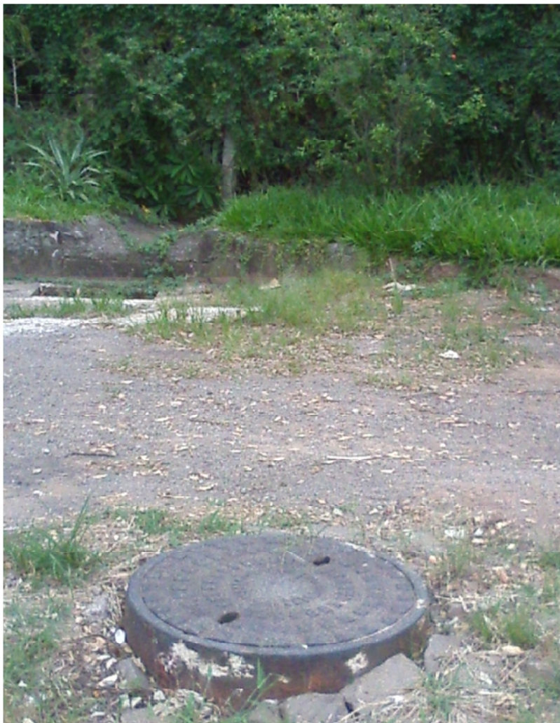
Foto 04 – Bueiro próximo ao curso de água da Sanga do Hospital
