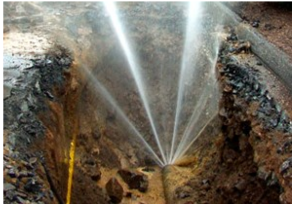
Figura 2. Flagrante de vazamento no Sistema Fonte: Do Autor, 2014.
