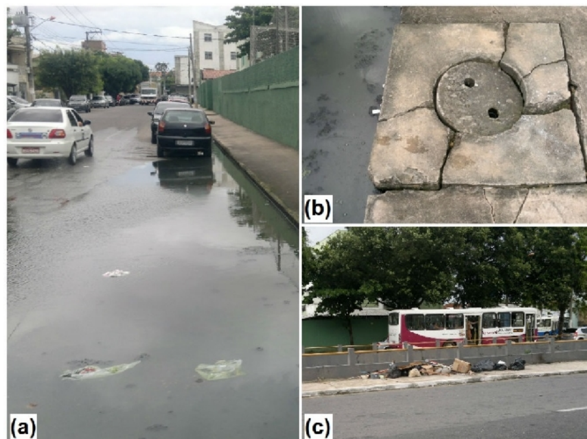
Figura 5– (a) Alagamento; (b) Dispositivo danificado; (c) Acúmulo de RS. Fonte: Autor, 2013.
