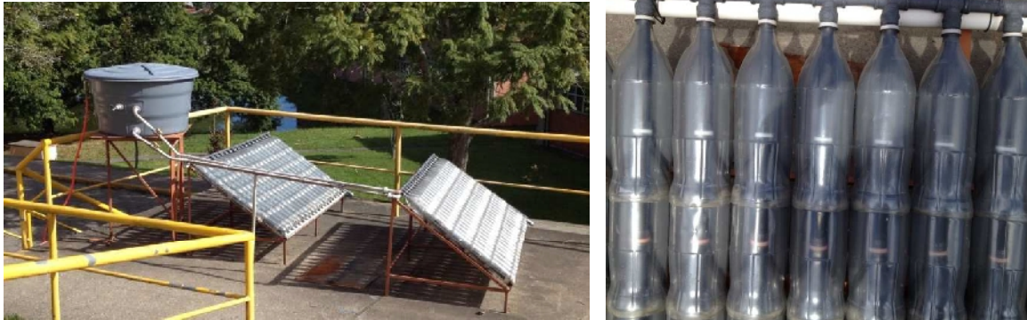
Figura 19: Sistema de Aquecimento Solar de Água com Garrafas PET
