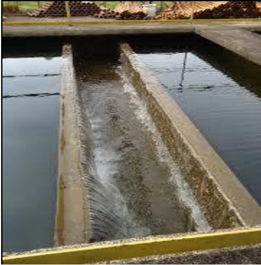
Figura 11 – Filtração de E.T.A
